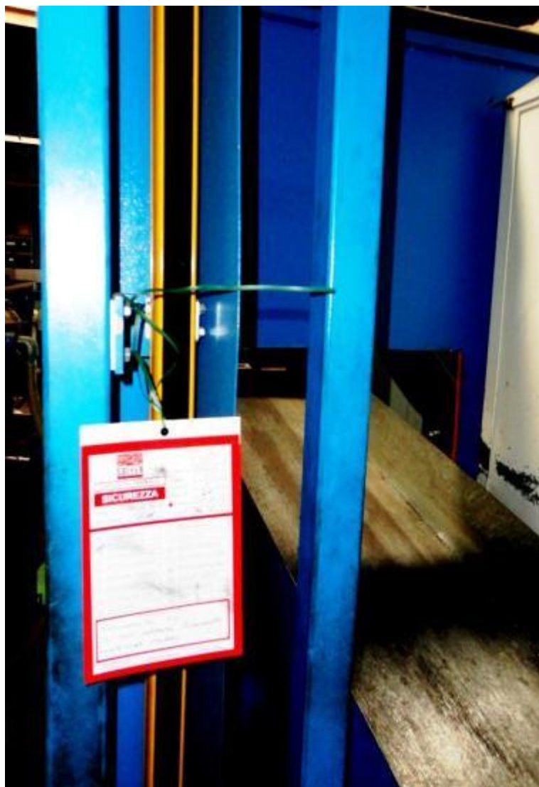
ROBOT BMW Barriera protezione fotoelettrica NON funziona
